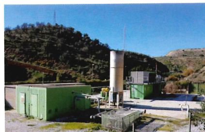
Vista de la planta de tratamiento
