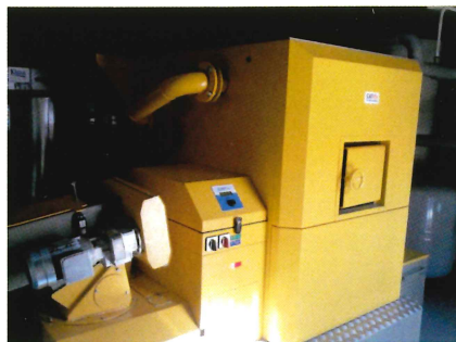
Caldera de biomasa
